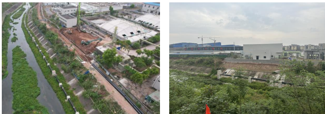
图1-2 取水泵房扰动现状
